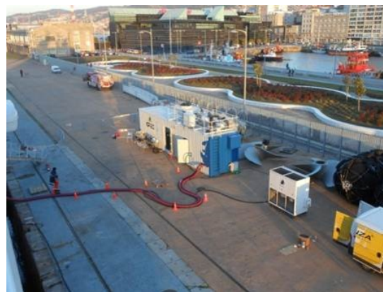
Sistema contenerizado clusterizable de poligeneración que suministra energía eléctrica y térmica a los buques.
